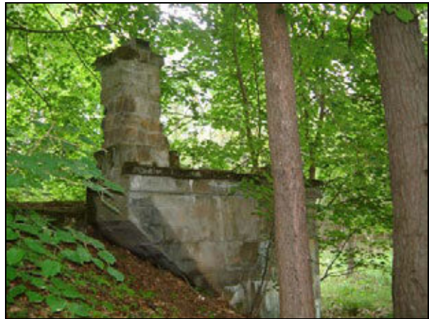
Reste der Sandfurtbrücke, im ehemaligen Kanalbett stehen hohe Bäume 2003
